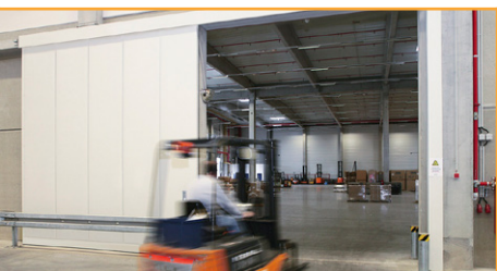
Für kraftbetätigte Brandschutztores ist eine audiovisuelle Signalisierung Pflicht.
